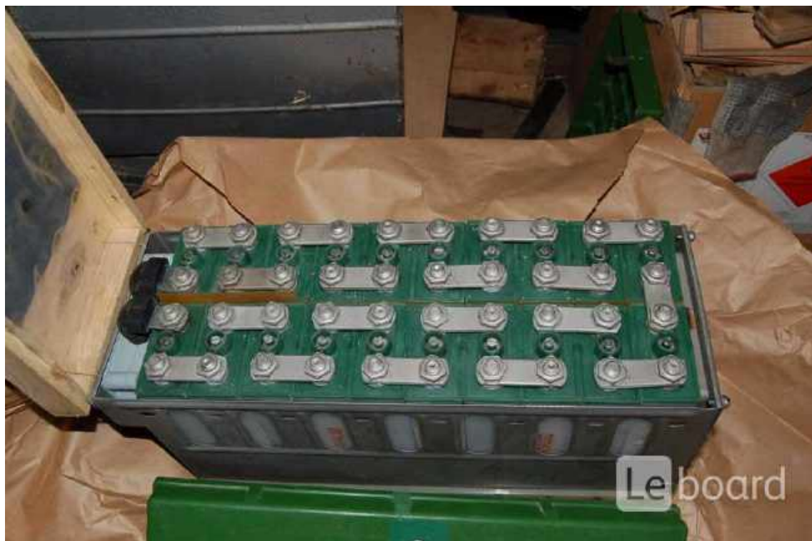
Рис 2. Аккумуляторная батарея 20 НКБН-40.
